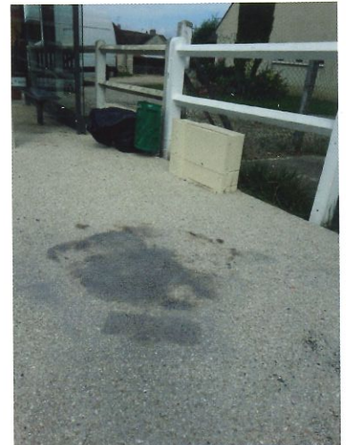
Brulure du béton lavé sur le trottoir, suite à un barbecue sauvage fait dessus.
